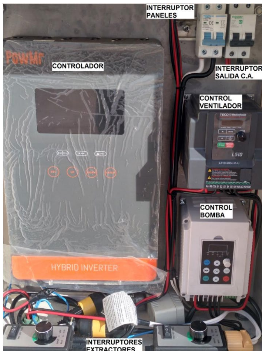
Figura 3. Caja principal de equipos del SFV dedicado a la bomba, ventiladores y extractor.
